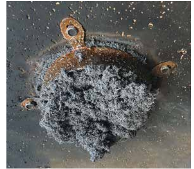
Feuer- und heißgasdichter Verschluss nach dem Auslösen der Brandschutzmanschette
