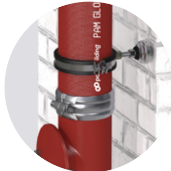
Detailansicht: TYRODUR Rohrschelle und zusätzlicher PAM GLOBAL® Akustikdämpfer
